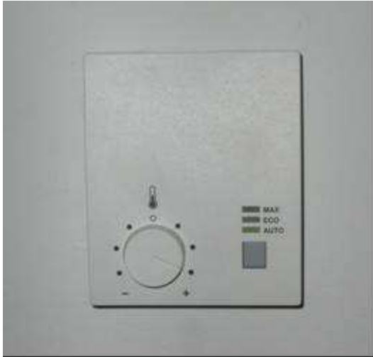
Abbildung 49: Bedieneinheit in den Wohnungen für Lüftung und Raumtemperatur
