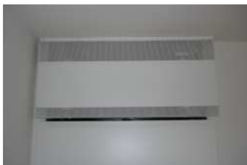
Abbildung 14: Raumheizung in den Wohnräumen
