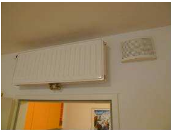
Abbildung 46: Heizkörper über der Tür
