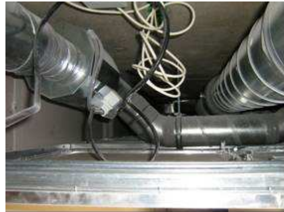
Abbildung 52: Volumenstromregler vor Wohnungen in Zwischendecke
