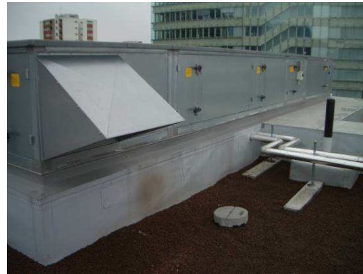
Abbildung 17: KWL-Anlage am Dach
