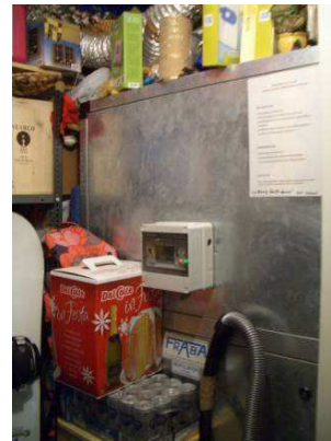
Abbildung 9: Dezentrale Einheit im Abstellraum
