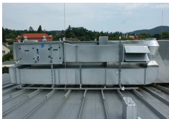
Abbildung 34: Lüftungszentrale am Dach
