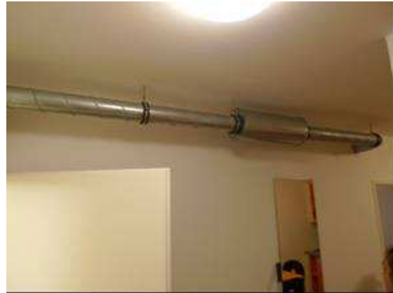
Abbildung 45: teilweise Sichtinstallation in den Wohnungen
