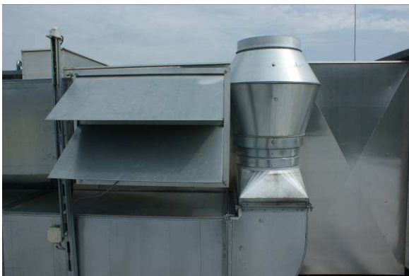
Abbildung 37: Zu- und Fortluftöffnung
