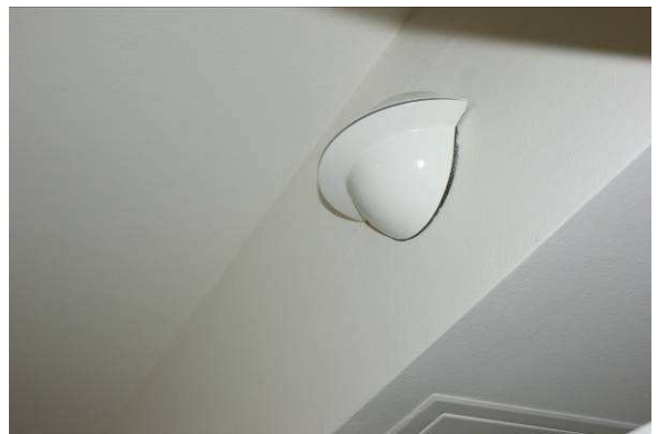
Abbildung 38: Zuluftöffnung in Wohnungen
