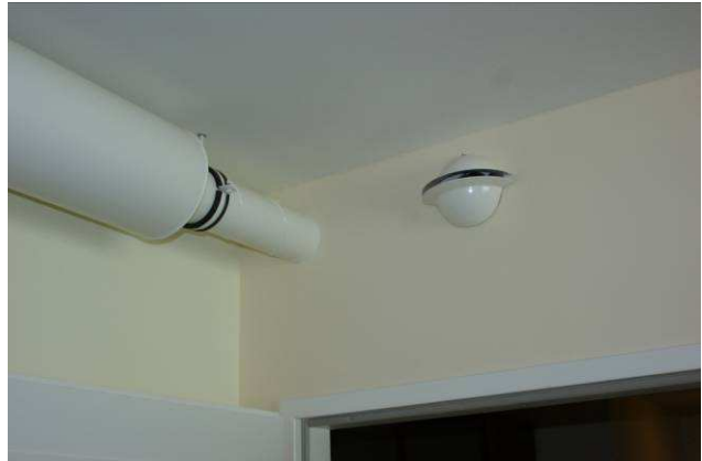
Abbildung 23: teilweise Sichtinstallation in den Whg
